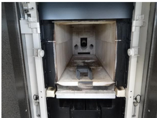
写真 3 台車式火葬炉
