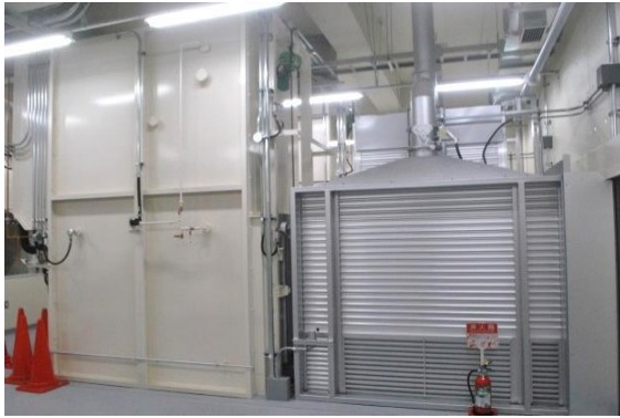
写真 1 前室付火葬炉設備
